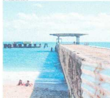
PONTE VELHA, no Poço da Draga, fechada após parte da estrutura desabar
